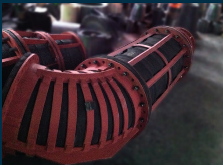
Резиновый трубопровод ДУ 630 в металлическом каркасе
